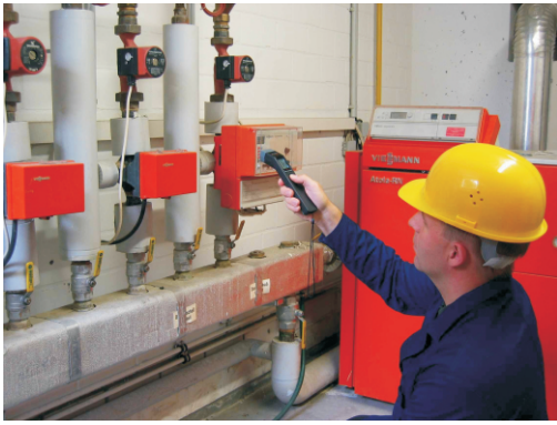
Überprüfen der Temperatur an Heizkreisen
